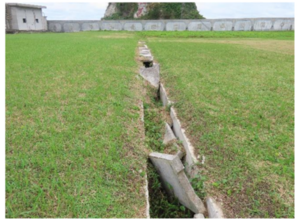
圖 貳-6 莊敬營區原有水溝現況照
