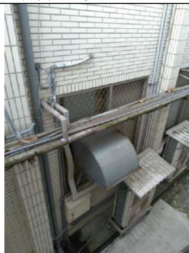
圖 2- 18 後期裝設冷氣管線外露
