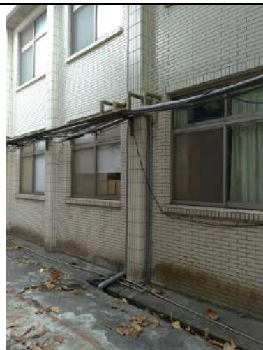
圖 2- 20 冷氣管線穿孔
