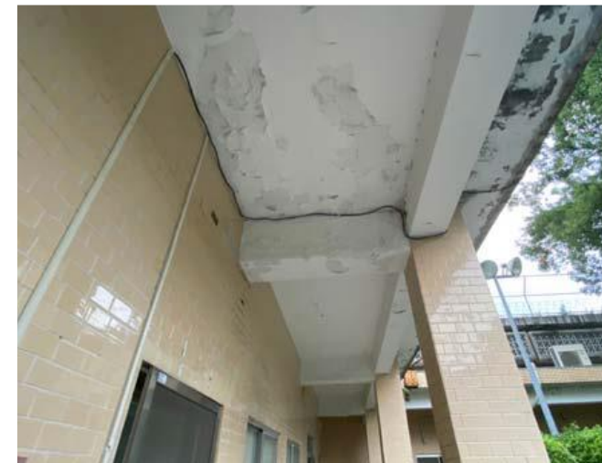
迴廊頂板受潮剝落
