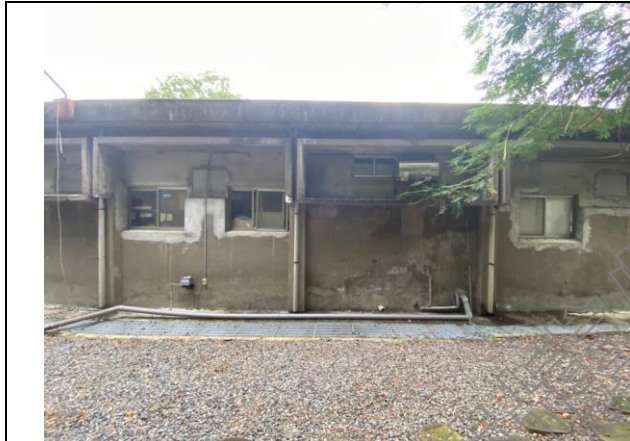
圖 2- 9 外牆僅表面粉光長年累積汙損及滲水現象
