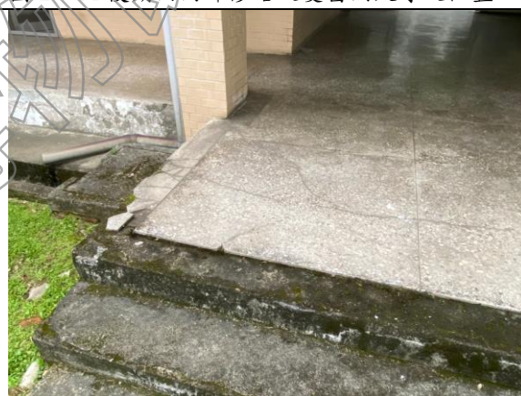
圖 2- 16 入口連接中庭地坪磨石子地板損壞
