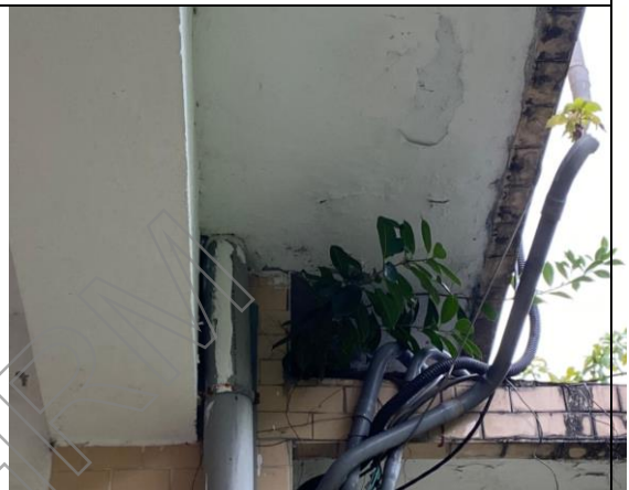
圖 2- 12 部分頂板植生造成滲水
