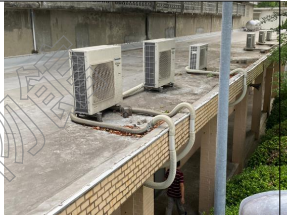
圖 2- 10 後期屋頂裝設冷氣室外機，管線外露
