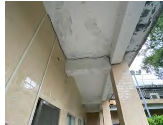
迴廊頂板受潮剝落
