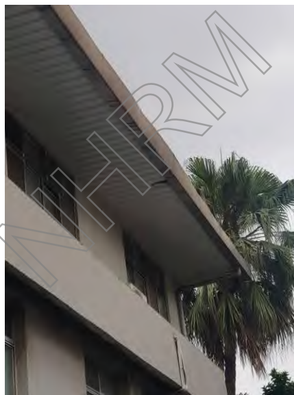
建物現況屋頂破損
