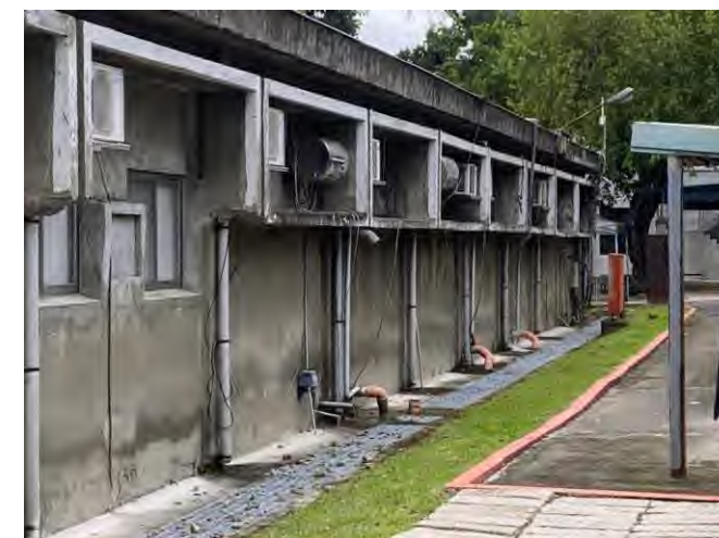
後期因內部修繕改變窗洞尺寸及位置
