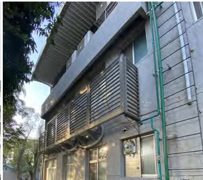
建物背側管線
