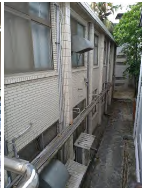
建物背側管線
