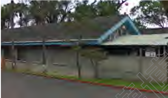
3. 南側立面無上漆，且部分門窗開口被封閉
