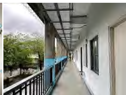
3.二樓走廊設有管線走線盒
