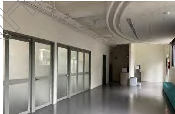
4. 二樓天花板部分無施作，部分管線為明管
