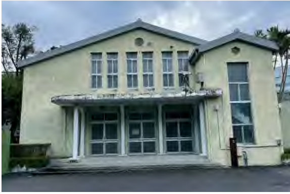
1. 西向立面外觀可見雨遮板表面髒污明顯
