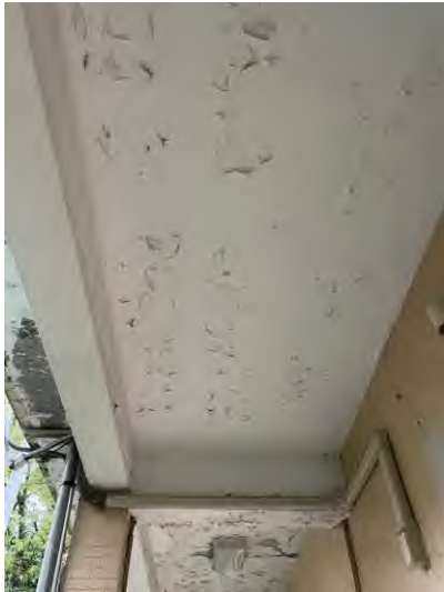
1.中庭側走廊天花板油漆剝落
