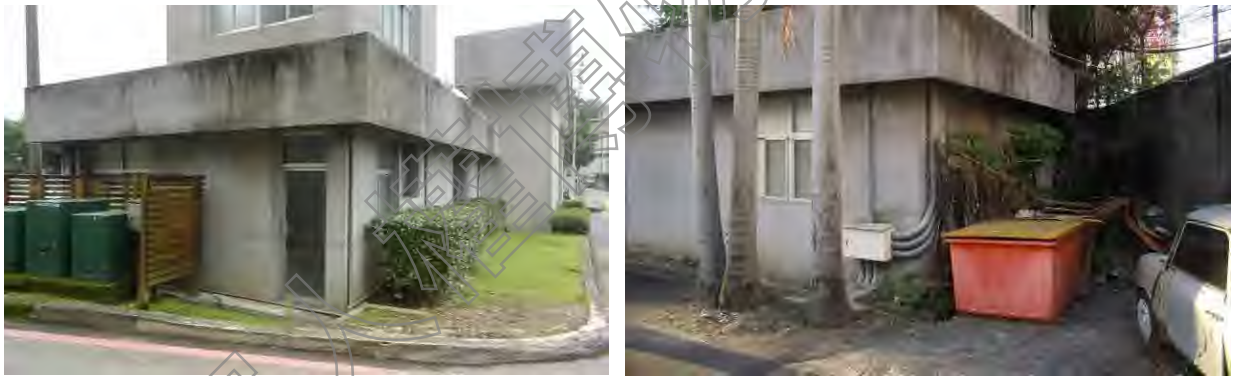
1.入口旁警衛室後門與綠帶緣石無連接
