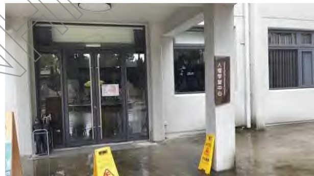
2. 正立面的落柱、落水管等陰角處皆有髒汗水痕，表面易髒汙。
