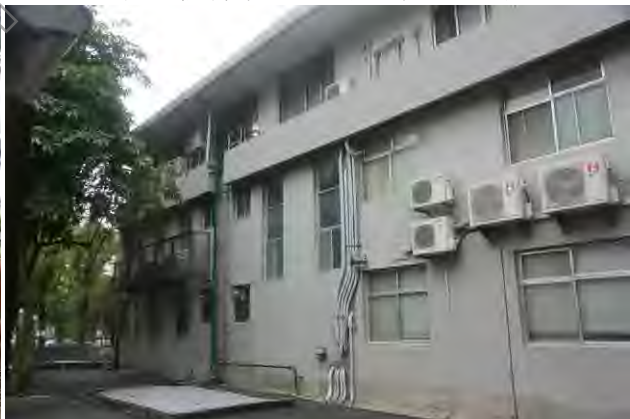
6.南向壁面設置多種管線及室外機
