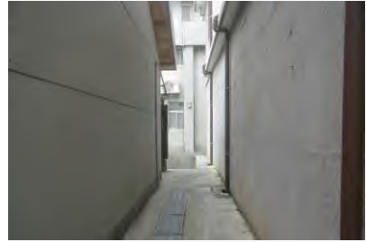
12. 原軍法學校閱覽樓和圖書館兩棟建築修復後，原連接部分已脫開，兩棟間設有排水溝。
