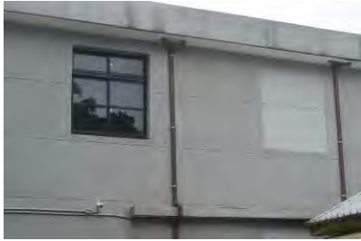
10. 西向立面留有開口更動痕跡
