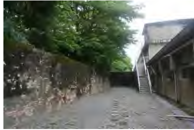
7. 軍法局看守所後方圍牆水泥表面剝落後，磚牆外露
