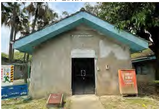
3. 東側立面有開口及壁面斑駁
