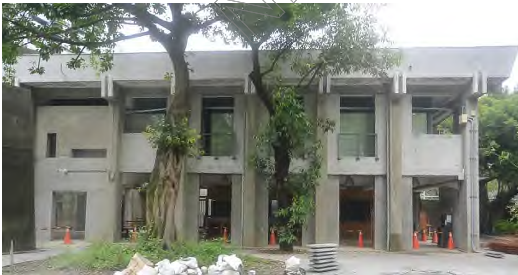
1. 軍法處辦公大樓南向現況立面，新舊混凝土色差明顯
