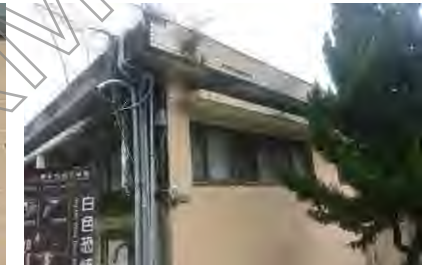
4. 管線多雜亂攀附於東向壁面
