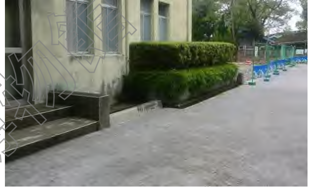
7. 戶外簷廊外緊鄰柏油鋪面，無犬走及排水溝
