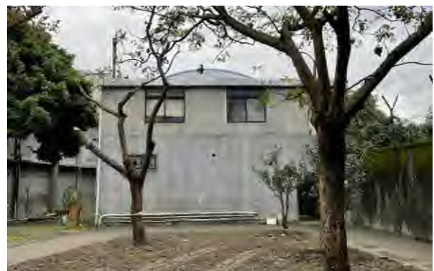
2.建築基礎無設置犬走及排水溝
