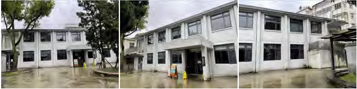
2. 建築南向立面入口雨遮、樓梯、落水管陰角處等皆有髒汙水痕。
