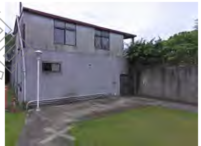
11. 小型看守所圍牆與既有圍牆表面材質不同
