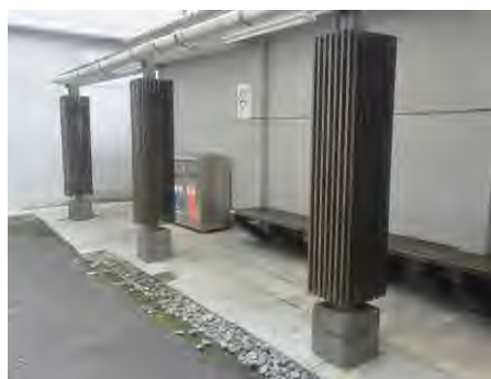
1. 簷廊下方的基礎板延伸至柏油鋪面，前方設置碎石排水帶
