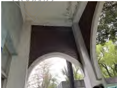
1. 室外走廊天花板油漆斑駁
