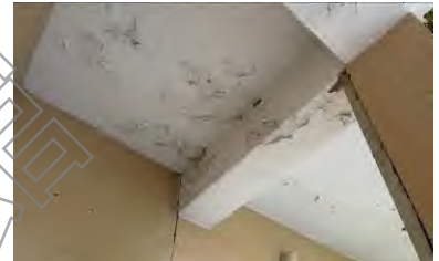
3.(上圖)屋頂出簷受潮嚴重;(下圖)靠外側天花板受損多
