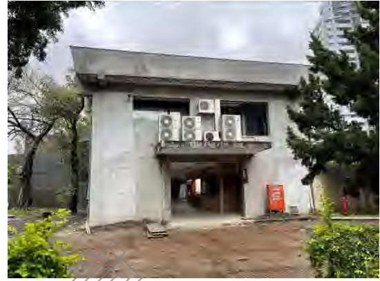
3. 東向立面現況，壁掛許多室外機且將喬木移除
