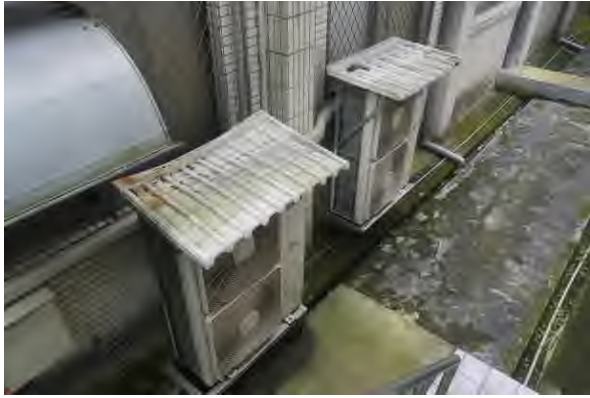
3.建築後方犬走及排水淺溝上設有空調室外機
