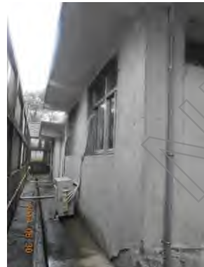
15. 內側圍牆與建築犬走、排水溝相近
