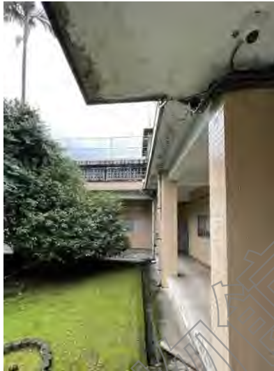
2.中庭側遮雨板油漆斑駁、受潮
