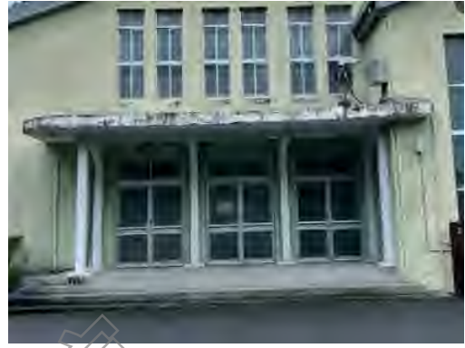
2. 入口雨遮板為表面因滲水而污漬明顯，而牆面漆料已褪色
