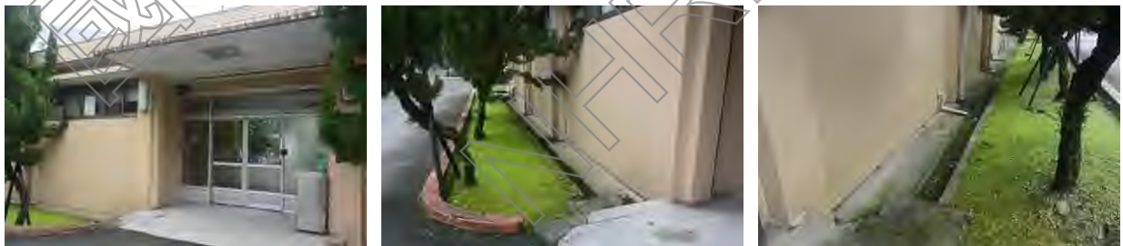
1.左圖為正入口鋪設磨石子地坪，與柏油道路齊平；中圖為入口左側犬走、排水溝及綠帶空間；右圖為入口右側犬走、排水溝及綠帶空間
