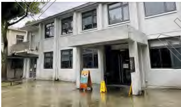
1. 建築正面無犬走及排水溝
