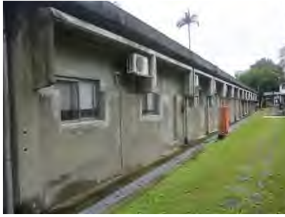
7.東向立面右半邊壁體更動痕跡
