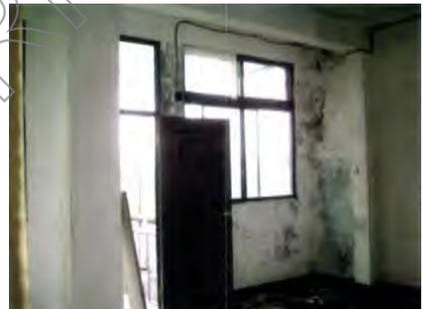
3. 室內天花板油漆斑駁
