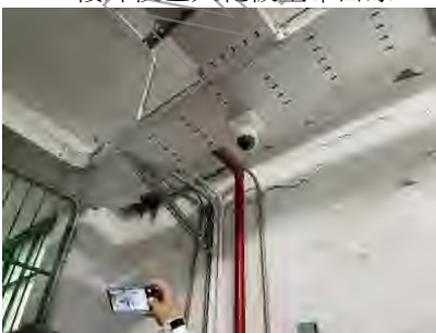
8. 押房區設有管線走線盒
