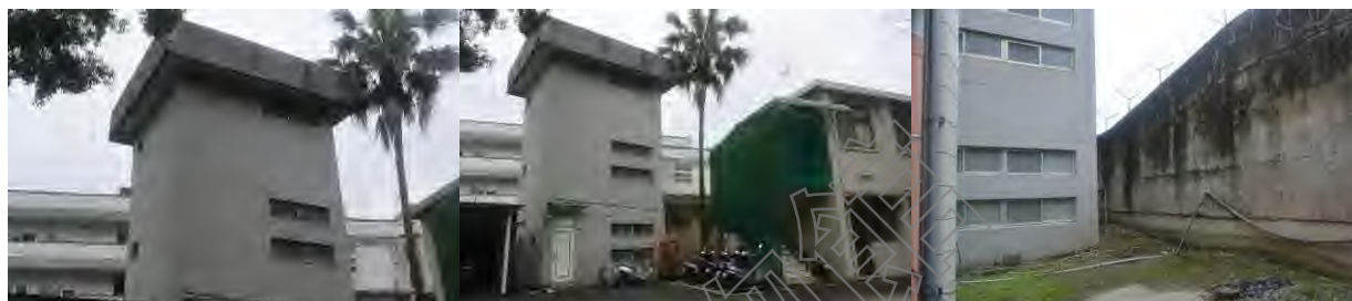
1.東向立面開口被電箱阻擋
