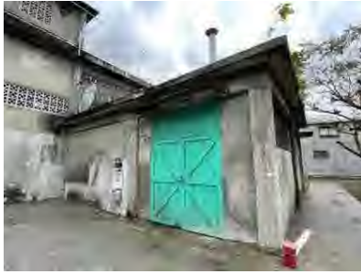
5.西側建築無犬走、排水溝
