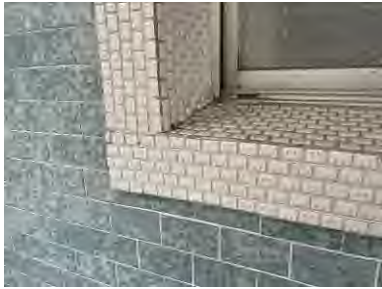
5. 簷廊牆面及窗框瓷磚尺寸不同
