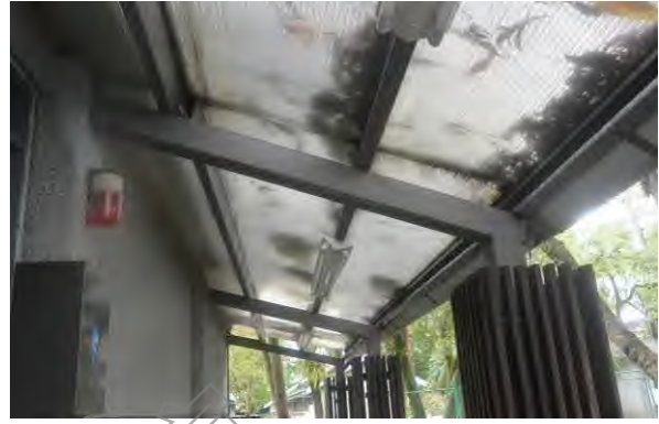
5.簷廊的鋼構架及 PC 中空板，落葉堆積難清潔
