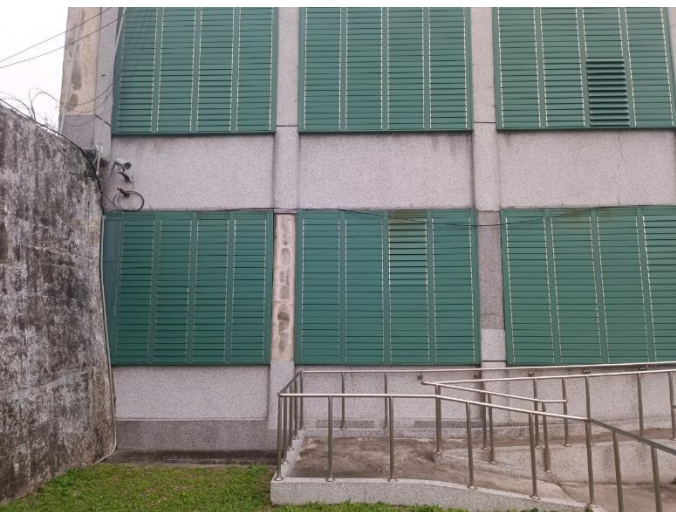
外牆洗石子剝落
