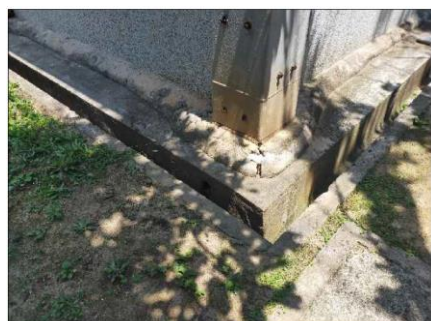
犬走裂縫破損
