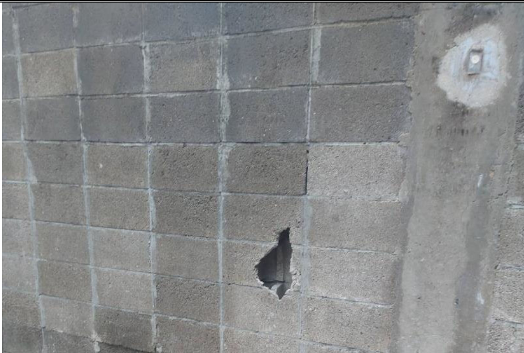
照片 8：圍牆表面孔洞。
