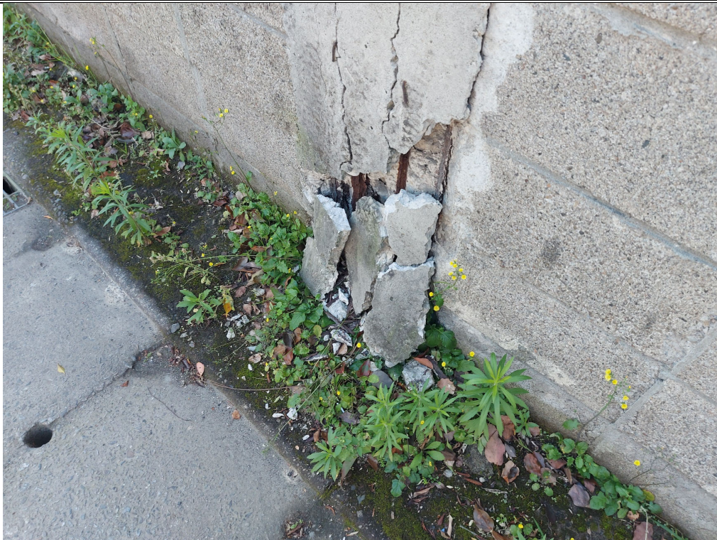
照片 4：圍牆柱表面混凝土剝落，鋼筋鏽蝕。
