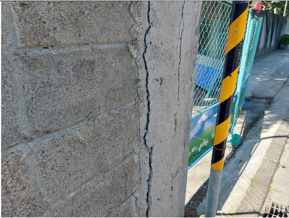
照片 5：圍牆柱表面混凝土開裂。
