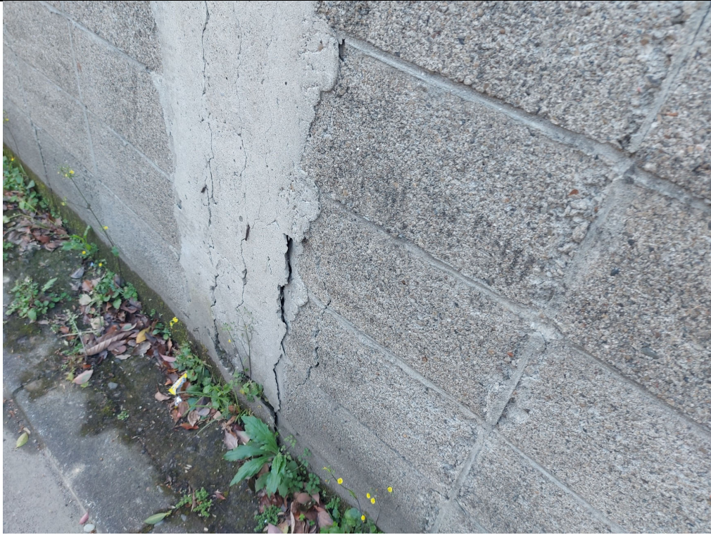
照片 7：圍牆柱表面混凝土開裂。
