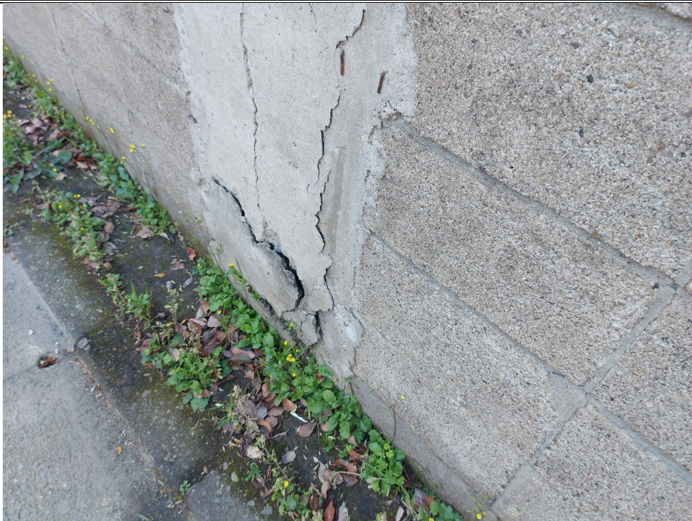
照片 6：圍牆柱表面混凝土開裂。
