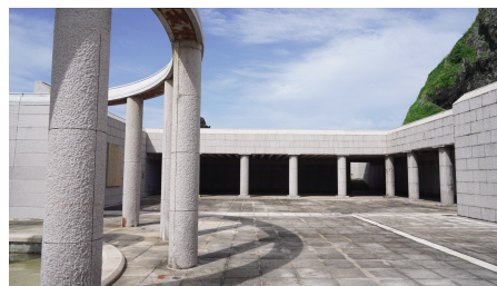
地坪石材與垂淚碑柱鹽害
