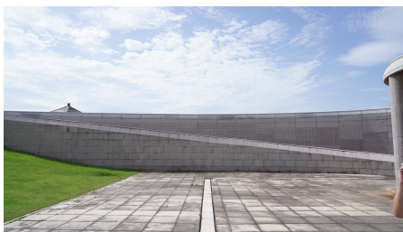
暗溝與地坪石材水斑
