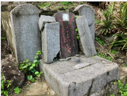
墓肩破損現況案例 (45-劉雲齊先人)
