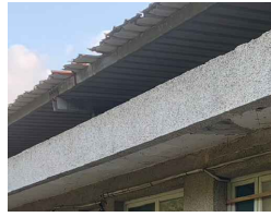
屋頂鋼棚破損處01
